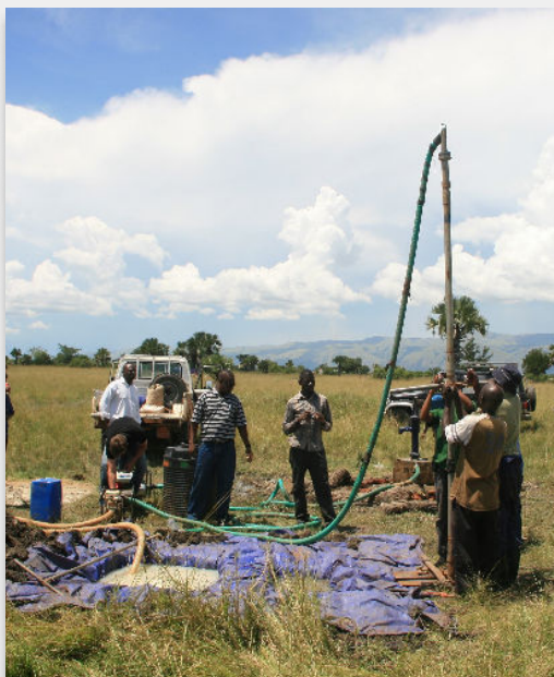
Une entreprise de forage, formée par Practica, est en train de réaliser une implantation de forage.
